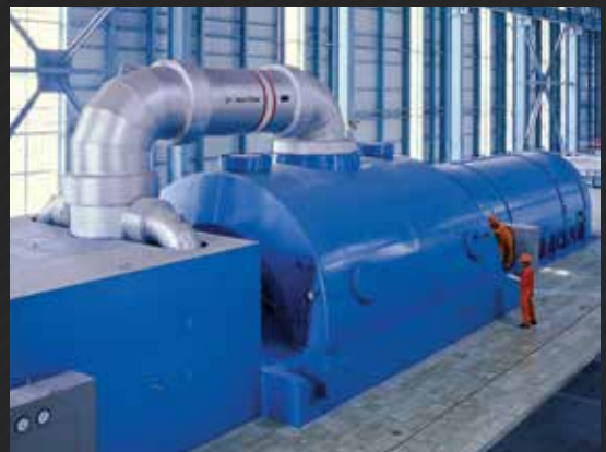
DÉTECTEZ LES FUITES DES GÉNÉRATEURS REFROIDIS À L'HYDROGÈNE
