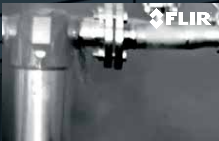
FUITE DE CO 2 - IMAGE INFRAROUGE
